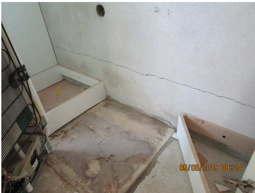
Kuva 4. Huoneistojen väliseinän vaakasuuntainen halkeama
