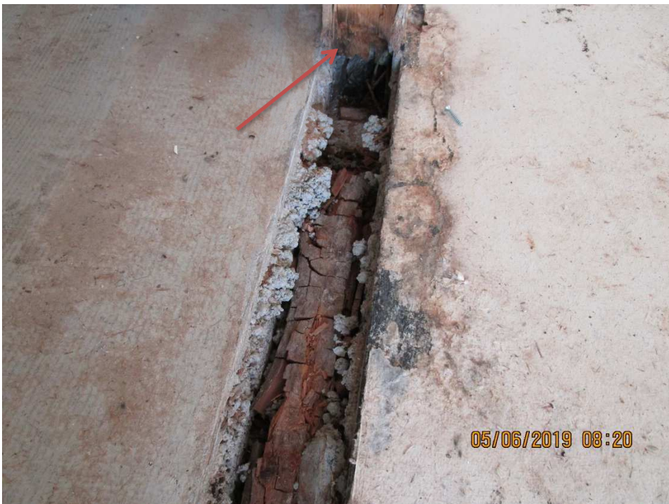
Kuva 2. Vaurioitunut väliseinän pohjapuu maanvaraisen reunavahvistetun betonilaatan päällä. Kuvassa näkyy selvästi runkotolpan alaosassa olevaa homekasvustoa
