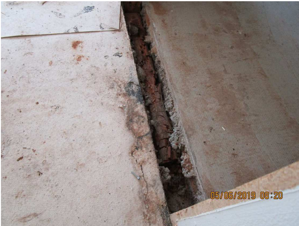
Kuva 1. Vaurioitunut väliseinän pohjapuu maanvaraisen reunavahvistetun betonilaatan päällä
