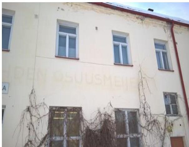
Kuva 5.2; Meijerirakennuksen räystäät vuotavat. Seinärakenteissa on vaurioita.
