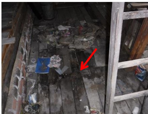
Kuva 8.1; Meijerin yläpohjassa vesikattovuotojen aiheuttamia vaurioita.
