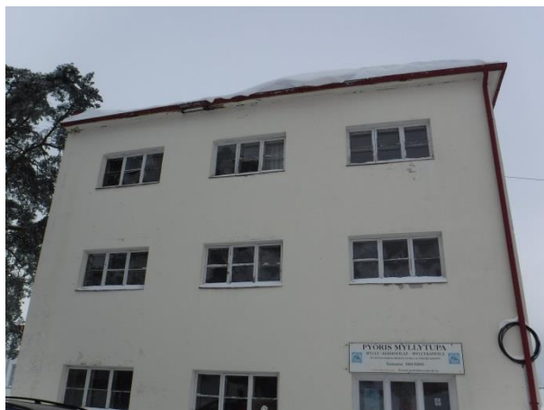
Kuva 6.1; Julkisivurappaus on kärsinyt, räystäiden lyhyys lisää ulkoseinän kosteusrasitusta. Räystäissä on lahovaurioita.
