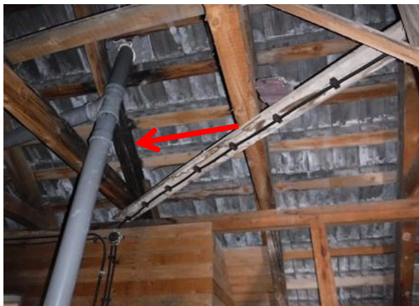
Kuva 8.2; Meijerin tiilikatteen alueella olevia kattovesivuotovaurioita.
