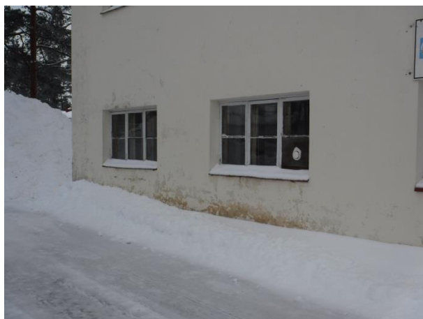
Kuva 5.1; Myllyrakennuksen seinien viereen on kasattu lunta, seinien alaosissa on kosteuden aiheuttamia vaurioita
